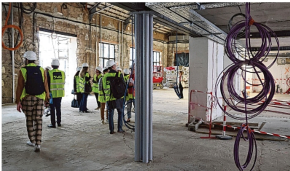
Le projet global va essayer de remettre en valeur le côté industriel du bâtiment. /PHOTO C.S.
